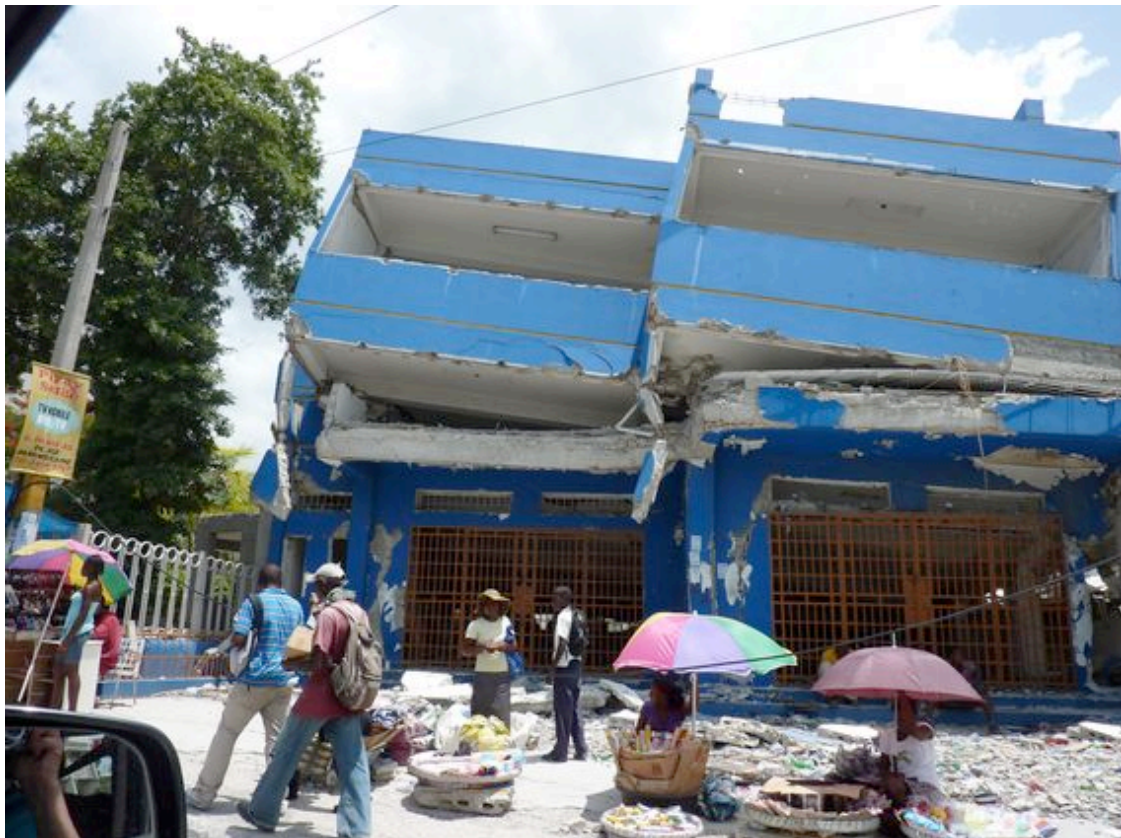
Malfaçons ou absence de normes ? Port au Prince (Boyer, 2010)
