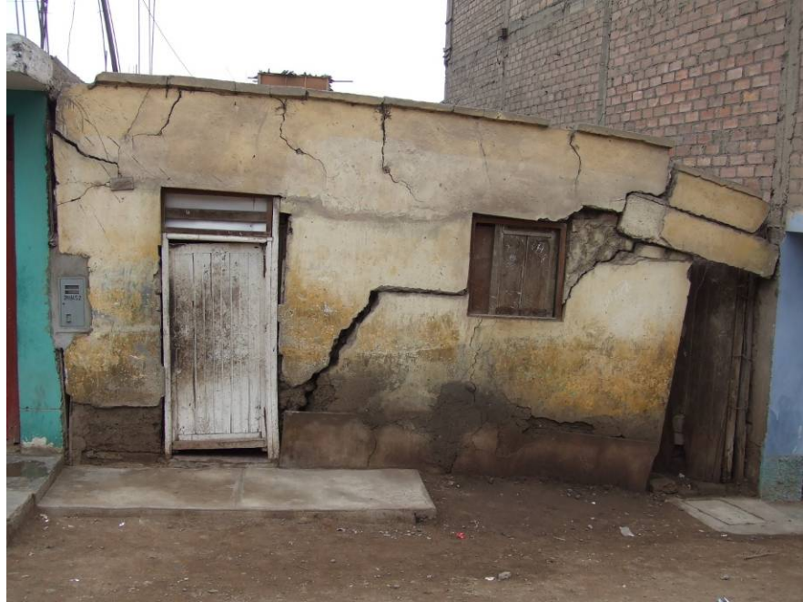
Photo 3 : Logement dans un des quartiers populaires du centre de la ville après le séisme de Pisco en 2007 (J. Robert, 2008)
