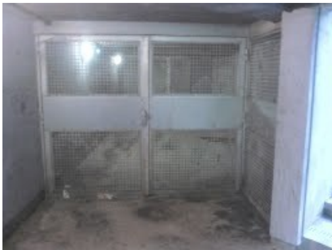
Grilles posées par l'administration en charge des lieux afin de bloquer l'accès aux sorties de secours du Carrousel du Louvre et mettre fin aux actes sexuels dans ce lieu (Lassaube, 2013).
