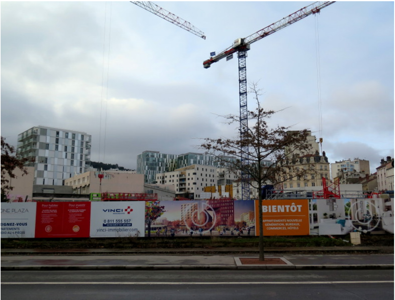
1. Chantier de construction neuve face à la gare de Châteaucreux, Saint-Étienne (Serra, 2017)
