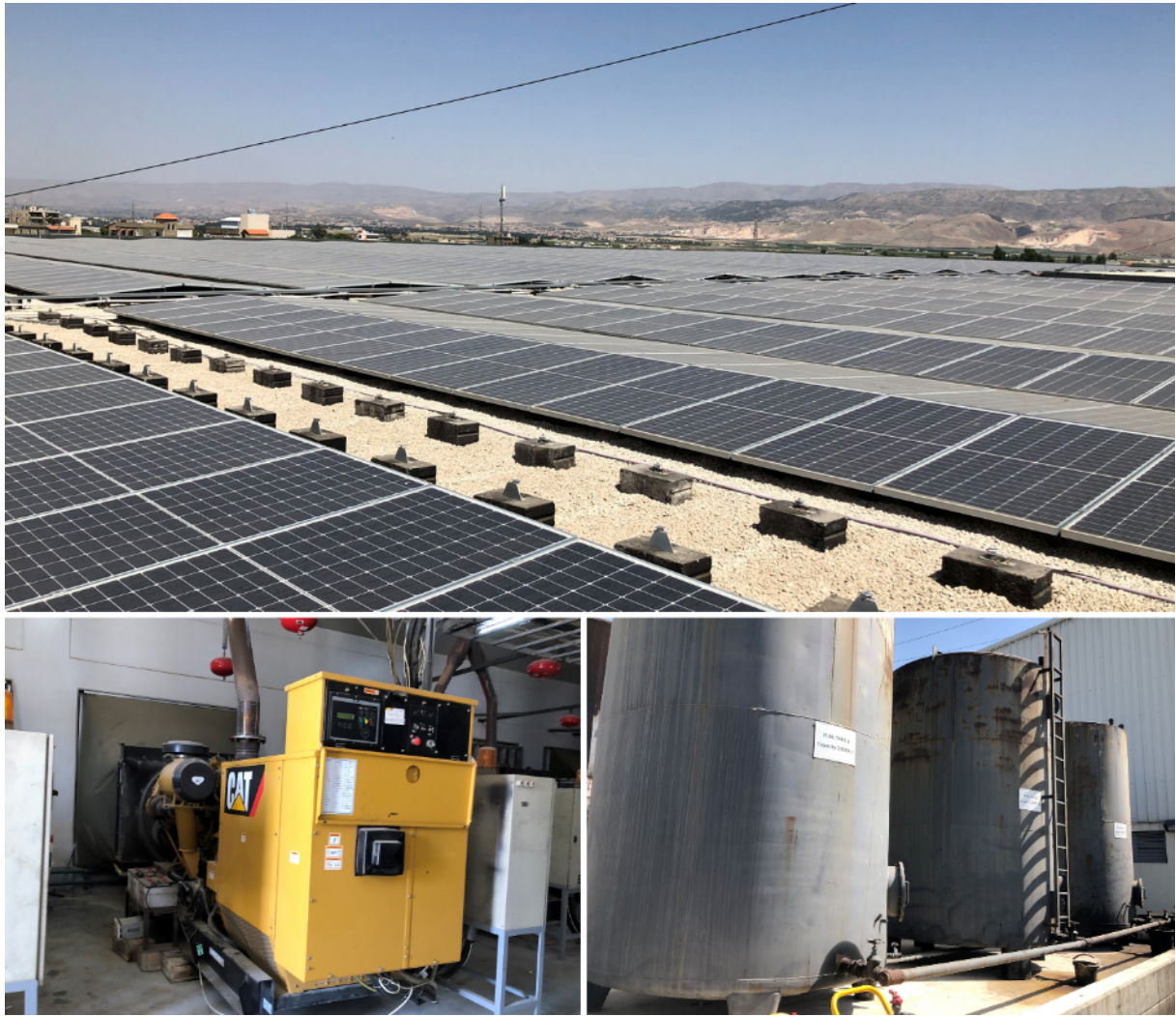
21. L'entreprise agroalimentaire de Daher Food articulant panneaux photovoltaïques (1,5 MW) et générateurs diesel (4 MW et cuves de fioul), et jouant d'une double connexion au réseau local de la concession d'électricité de Zahlé, ainsi qu'au réseau national libanais. Zahlé, Liban (Alix Chaplain, 2021)
