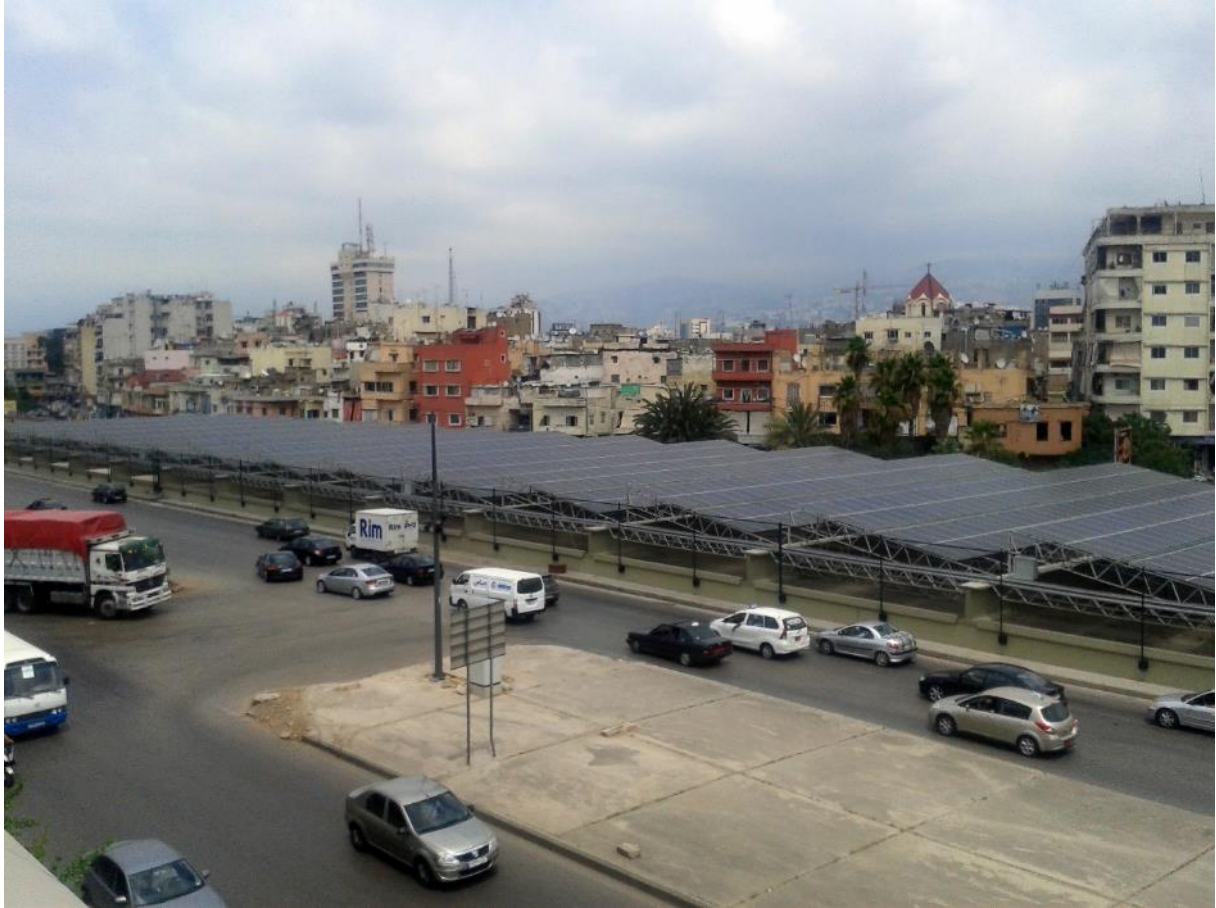
5. Système de production photovoltaïque public installé sur la rivière de Beyrouth et injecté sur le réseau national Électricité du Liban, Beirut River Solar Snake, Liban (Eric Verdeil, 2018)
