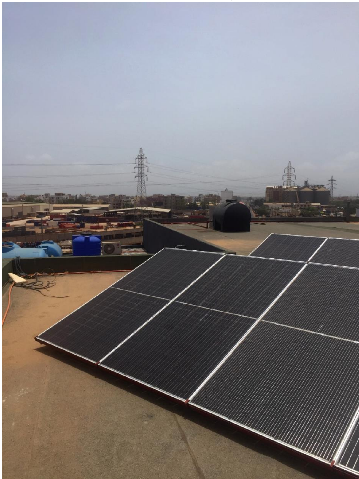
20. Installation PV sur toiture d'une entreprise commerciale dans une zone industrielle de Dakar, Sénégal (Tomy Goulding, 2022)
