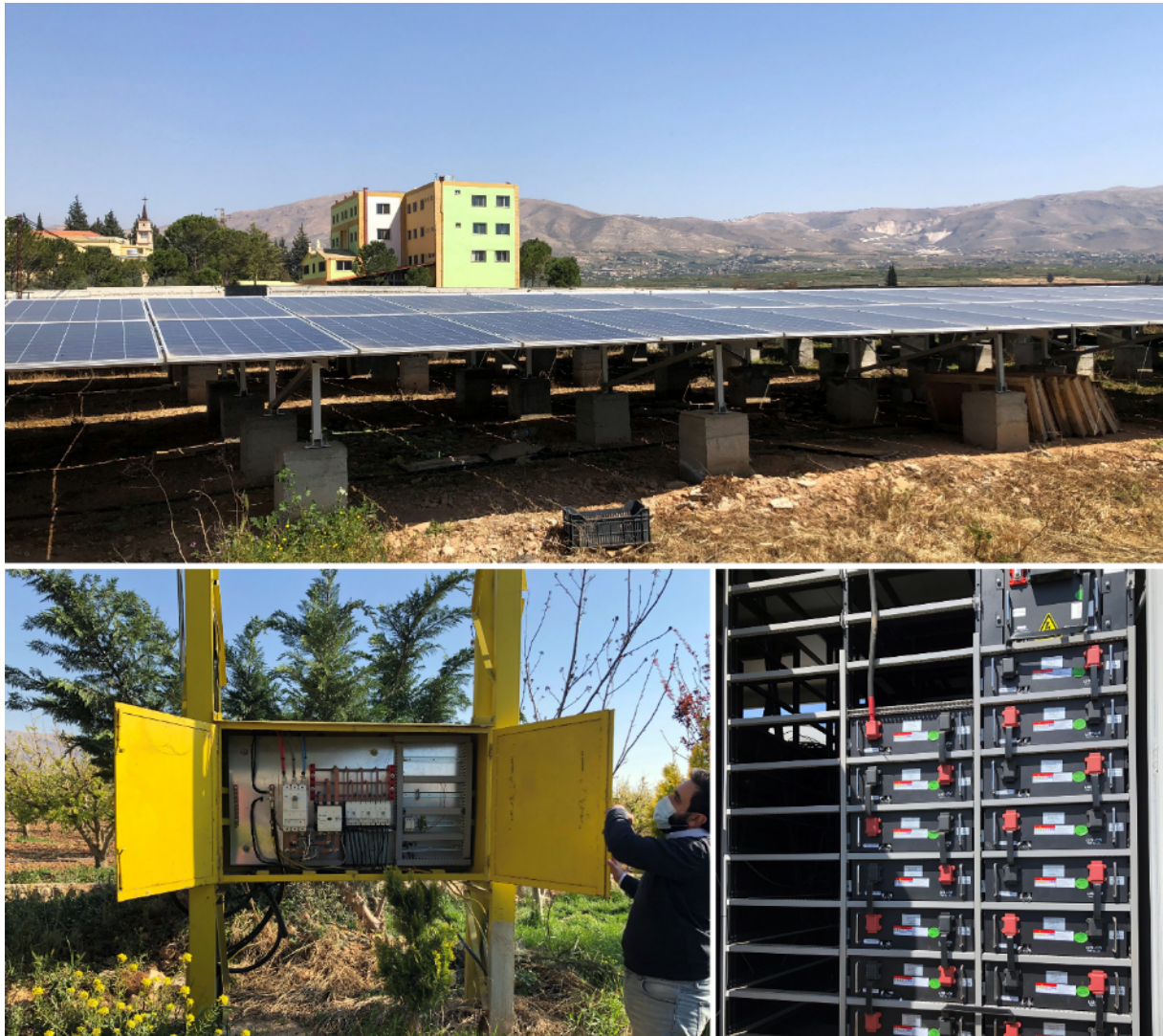
9. Composants d'un mini-réseau hybride photovoltaïque privé avec batteries géré par un opérateur privé dans le village de Jabbouleh, Liban (Alix Chaplain, 2021)
