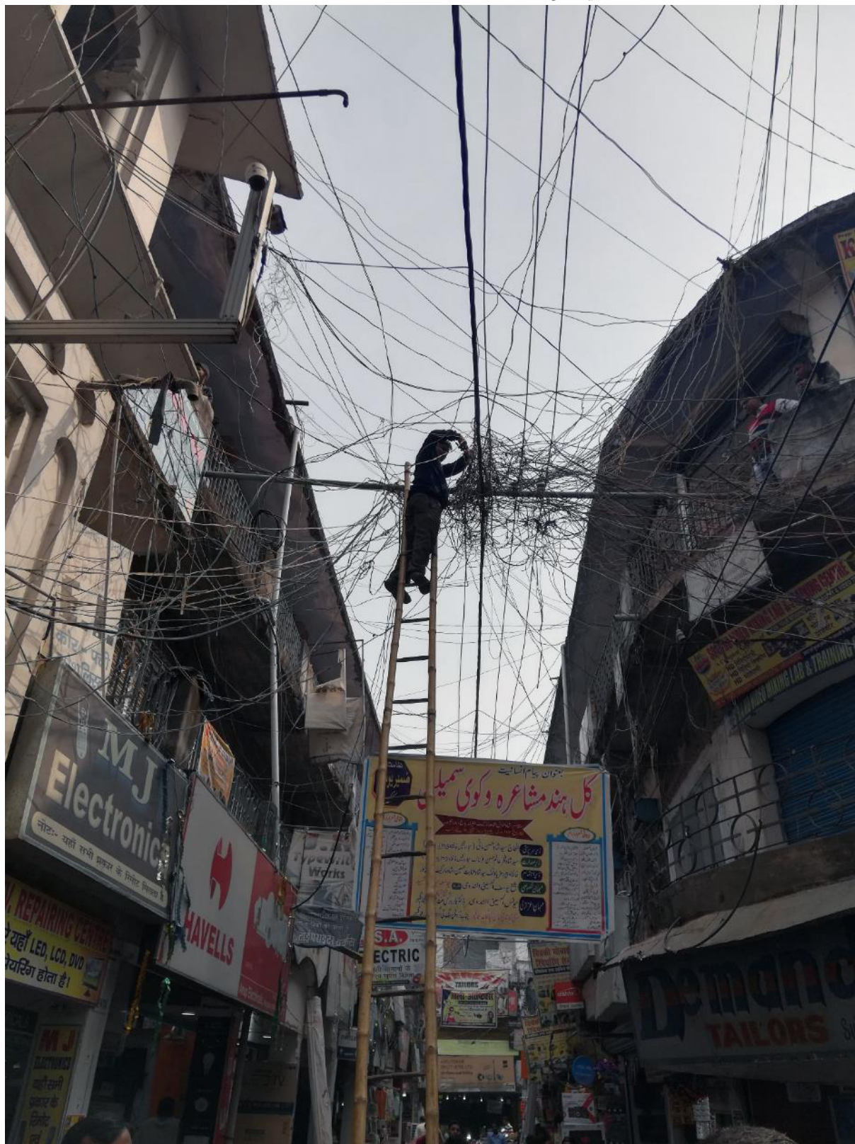
3. Un technicien répare un branchement défaillant. L'entremêlement des fils électriques nécessite des interventions régulières. Shah Market, Bhagalpur, Inde (Bérénice Girard, 2019)
