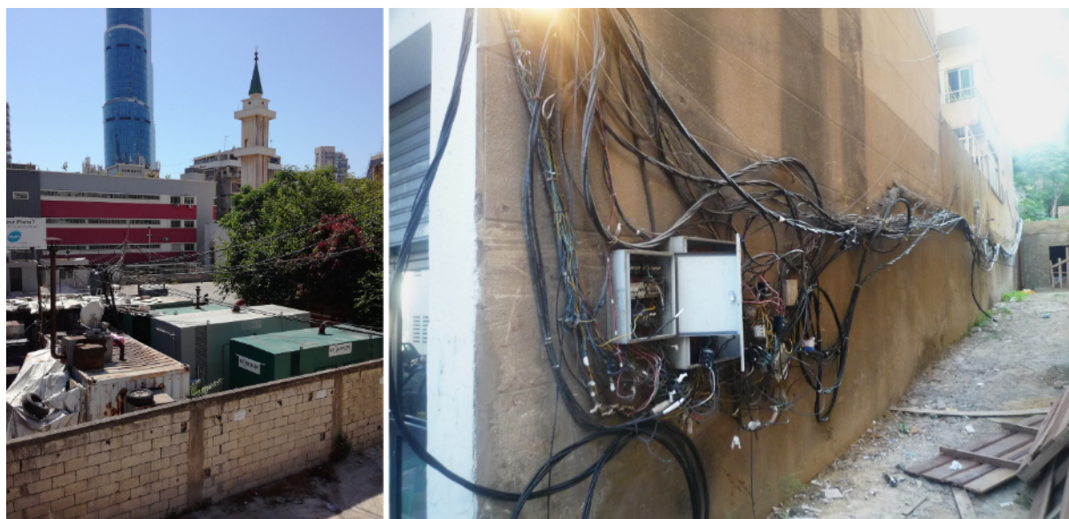
7. Mini-réseaux de générateurs diesel dans la ville de Beyrouth, Liban : un ensemble de générateurs sur une parcelle non-bâtie au cœur d'un quartier central en voie de densification et un écheveau de câbles du réseau de distribution privé avec l'armoire à disjoncteur (Éric Verdeil, 2021)
