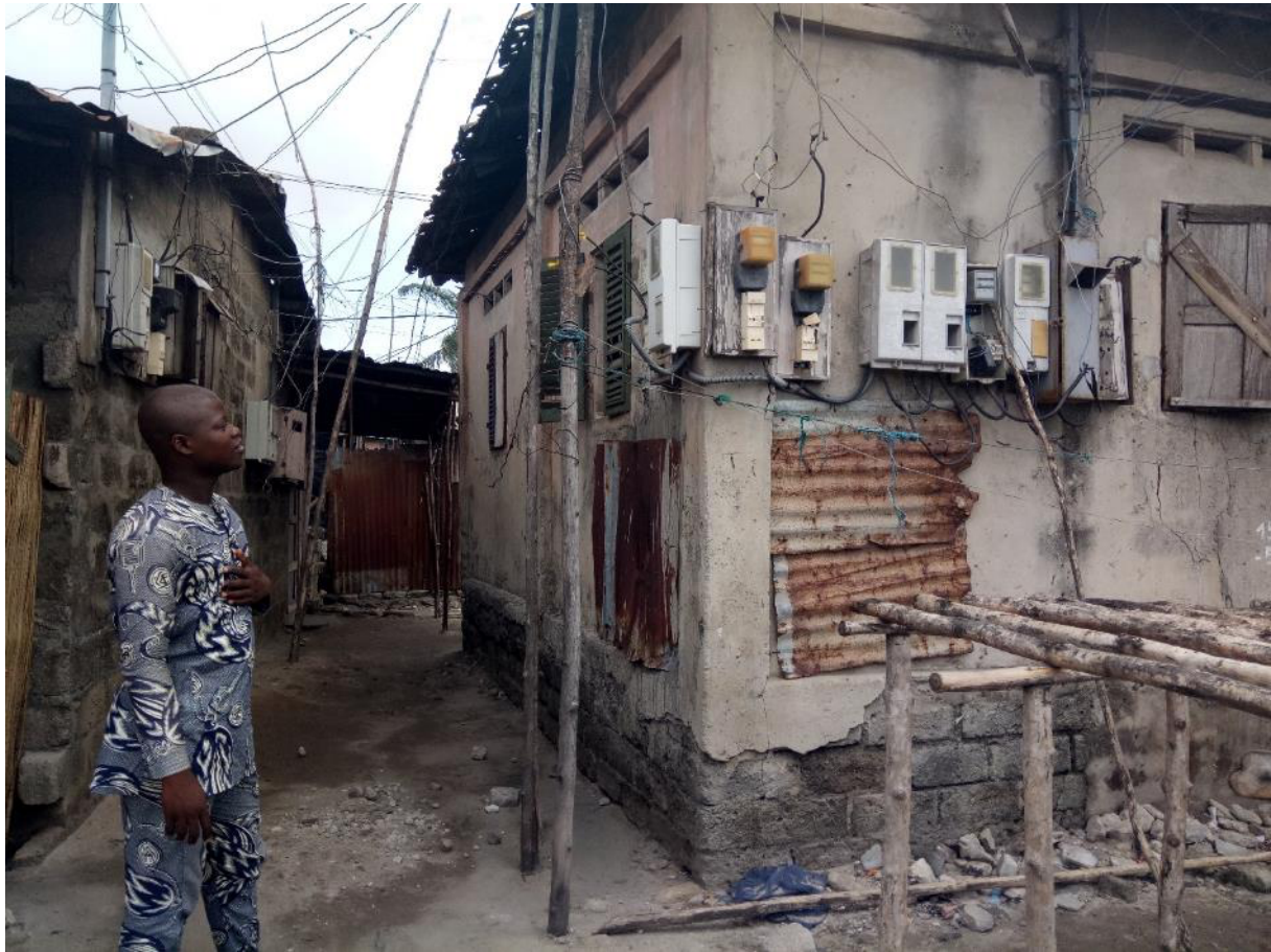
2. Compteurs installés sur la façade des maisons : points de départ des extensions bricolées à Cotonou, Bénin (Mélanie Rateau, 2018)
