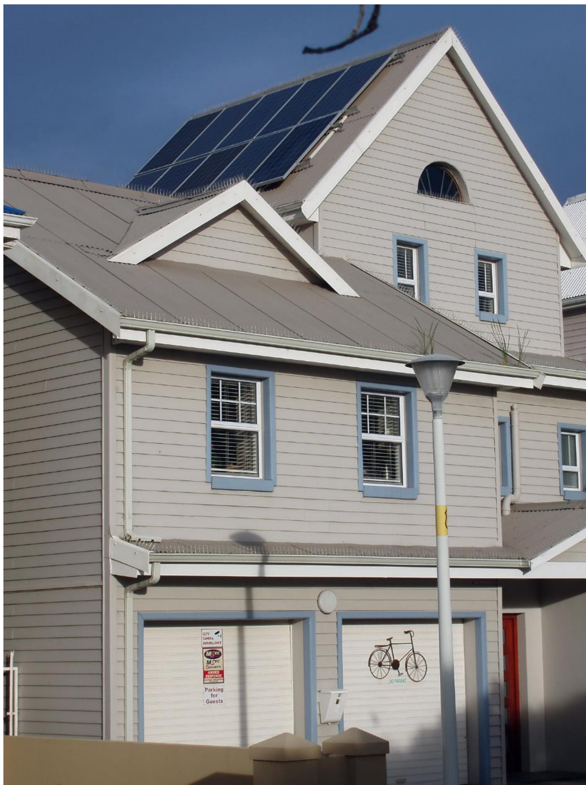
13. Panneaux photovoltaïques installés sur le toit d'une maison d'hôte et connectés au réseau municipal, Mossel Bay, province du Western Cape, Afrique du Sud (Alain Dubresson, 2018)
