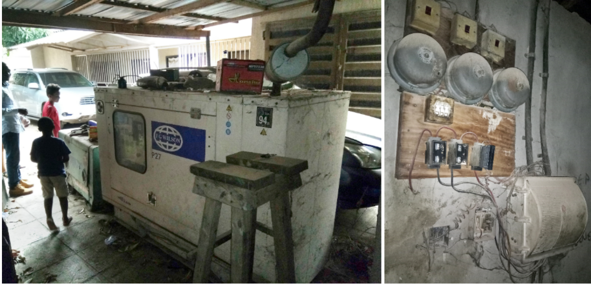
16. Les groupes électrogènes prennent le relais en attendant que les sonnettes avertissent du retour de l'électricité conventionnelle dans le réseau à Ibadan, Nigéria (Mélanie Rateau, 2018)
