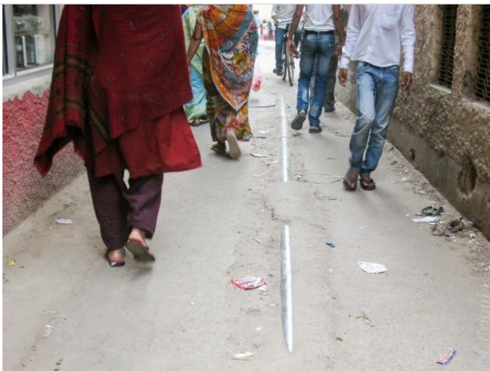
Photo 9. Canalisations superficielles dans la rue soumises aux intempéries, à l'érosion et à la circulation (Delhi, 10 mars 2013)
