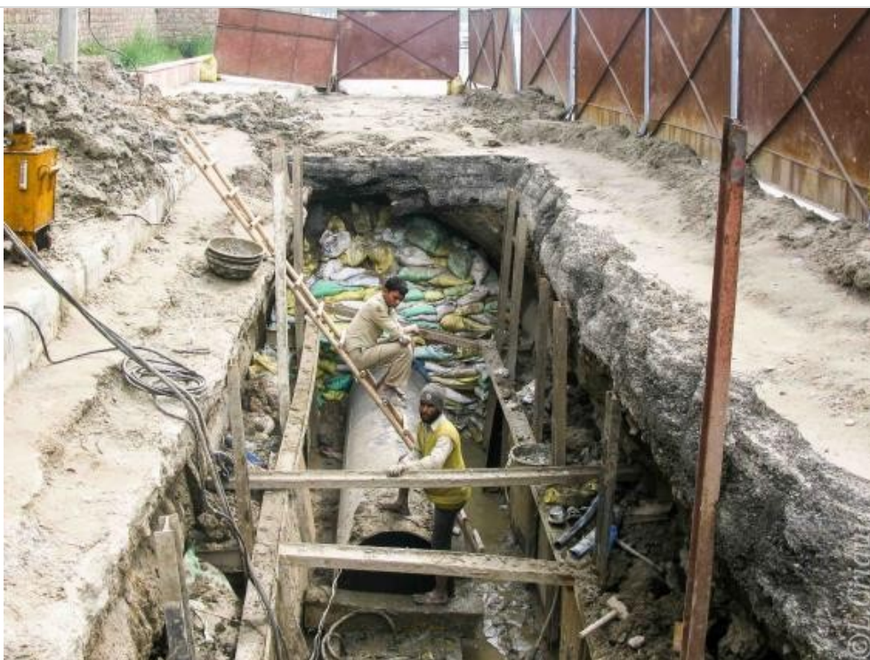
Photo 1. Sur le bord d'une voie rapide, des travaux de tranchées sont réalisés avec peu de considérations pour la sécurité : les tranchées ne sont pas protégées, les ouvriers n'ont aucun équipement de sécurité, les décombres ne sont pas stabilisés et les équipements et échafaudages de stabilisation des plus précaires. (Delhi, 19 février 2013)
