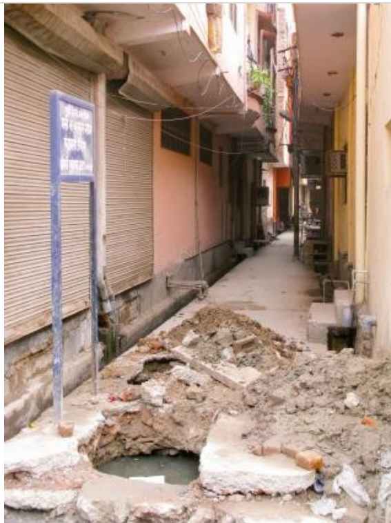
Photo 7. Dans ce quartier informel, et en période électorale, la rue avait été cimentée par la municipalité à la demande de l'élu ; trois semaines plus tard, l'organisme en charge de l'eau et de l'assainissement a de son côté décidé de réaliser des travaux d'évacuation des eaux usées et pour cela rouvert la voie nouvellement refaite. (Delhi, 11 mars 2013)
